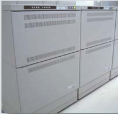
左:起床通報主制御装置 87249aC2 右:起床通報制御装置 87249aC4
